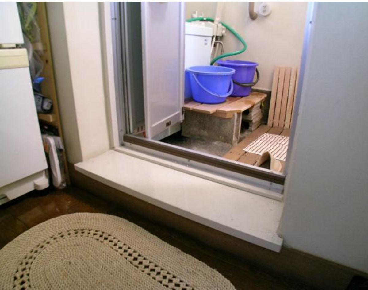
Sw1 単身女性 風呂場入口の立ち上がりの為、自宅で入浴できない。
