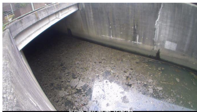
写真 - 1 スカムの発生状況
