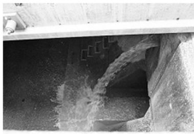
左)ビル地下に湧き出た地下水放流 (撮影2017年04月)
