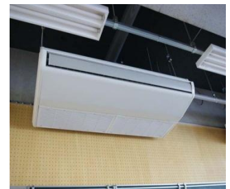
図9 ヒートポンプ式暖房機
