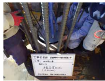
提案ビルに採用された省エネ、再エネの技術の例(左より)基礎杭に挿入された採熱管、給電制御の種類別に色分けされたコンセント、LED照明、太陽光発電、木製ルーバー、自然換気排気口
