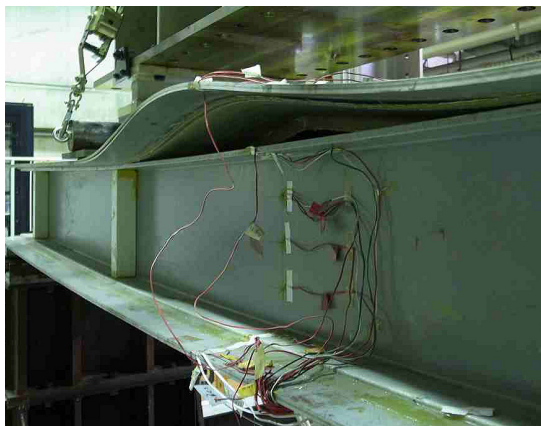
図-10 終局時の試験桁の破壊状況
