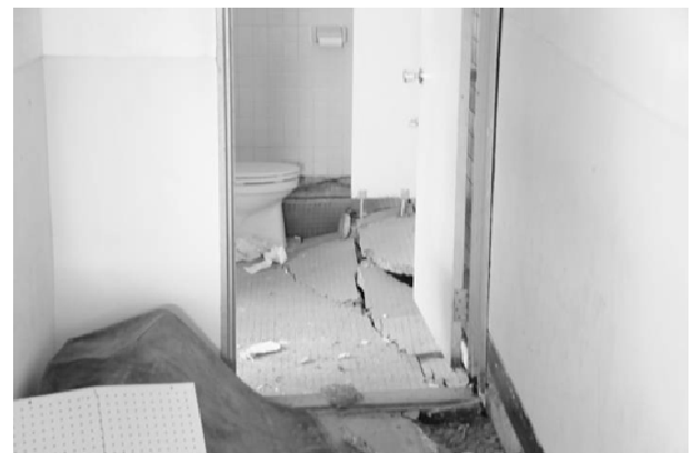
写真 4.2.5 1階床スラブの不同沈下
