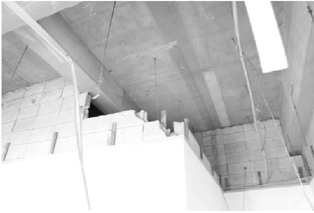
写真 4.2.6 コンクリートブロック壁の崩落
