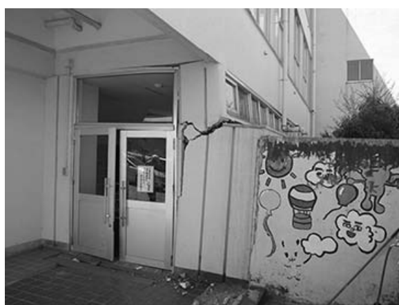
写真 4.2.17 北面 1 階の RC 雑壁の損傷
