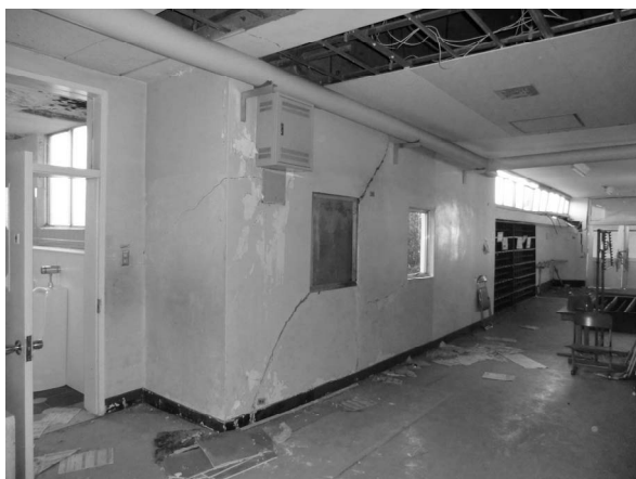
写真 4.2.16 北面 1 階の RC 雑壁のせん断ひび割れ
