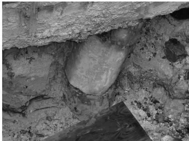
(b) 杭頭の折損と水平すべり
