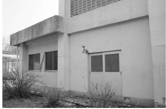
写真 4.2.7 D 通り開口壁のせん断ひび割れと方立て柱（左側）のせん断破壊
