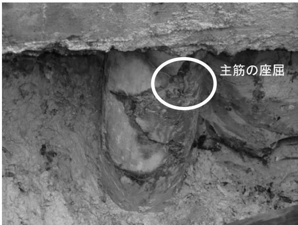
(a) 杭頭のせん断破壊と杭主筋の座屈
