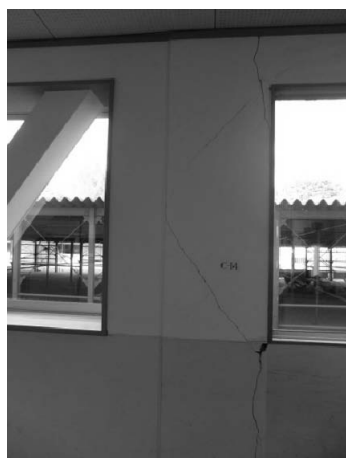
写真4.2.9 1階鉄骨ブレース脇のC-14柱のせん断ひび割れ
