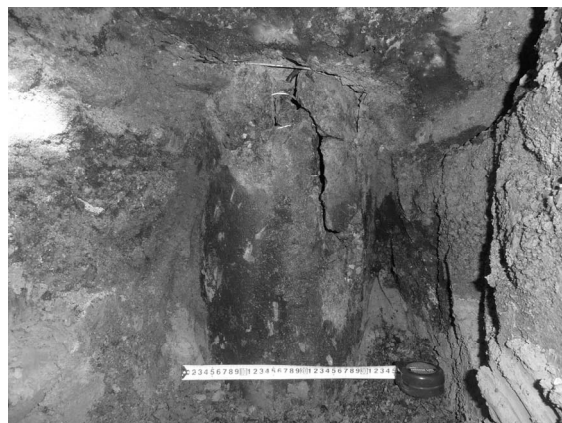
写真 4.2.19 杭頭の破壊状況
