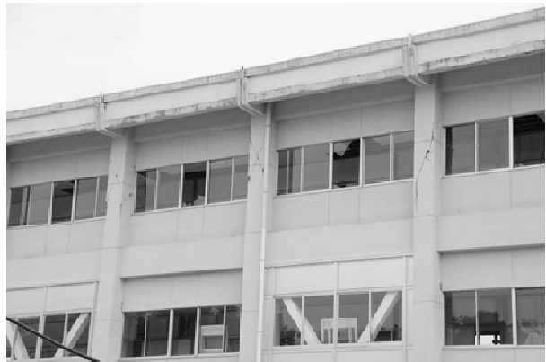
写真 4.2.2 普通教室棟 C通りの3階のせん断破壊
