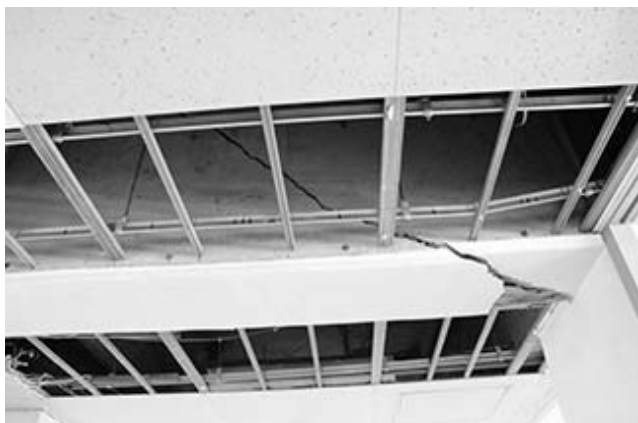
写真 4.2.18 張間方向の短スパン梁のせん断破壊
