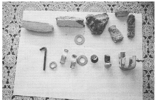
写真8 体育館天井から落下したリベット、コンクリート片など
