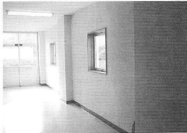
写真15 補強開口耐震壁（ほとんど損傷なし）
