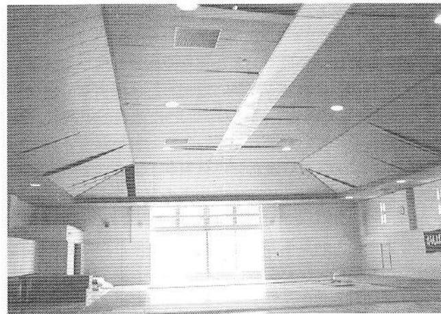
写真17 武道場・天井の仕上げ材が脱落し一部が落下
