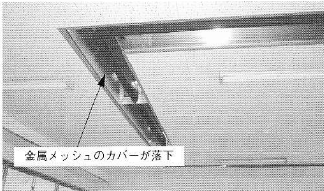
写真4 校舎棟天井暖房器具
