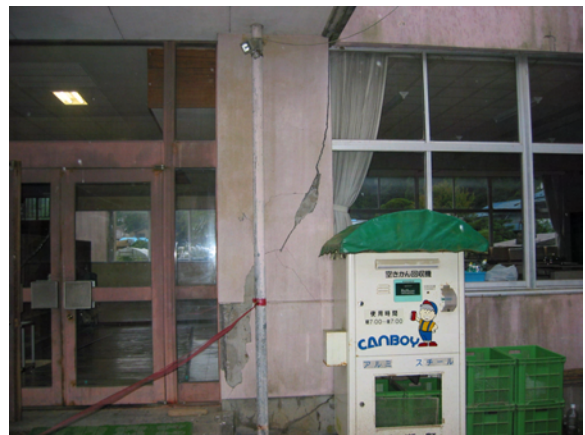
写真5.2 南側柱のせん断ひび割れ
