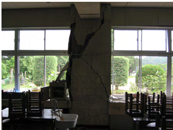
写真2.3 下階壁抜け柱のせん断破壊 (写真2.2の内側)
