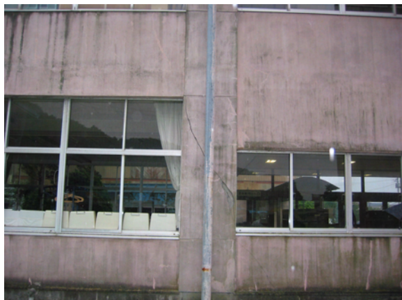
写真5.3 北側柱のせん断ひび割れ
