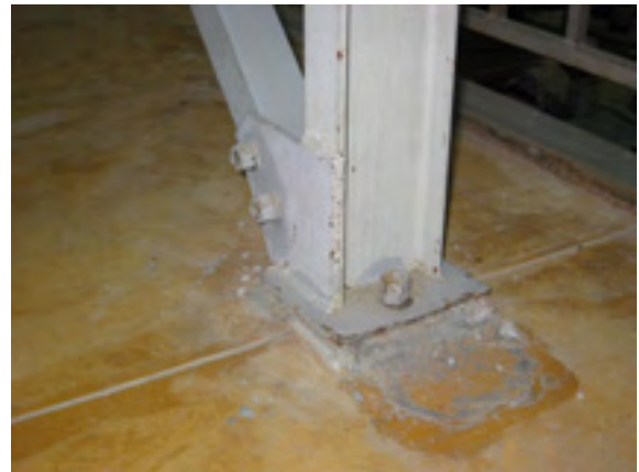
写真5.8 ブレース縦材のベースプレートの移動
