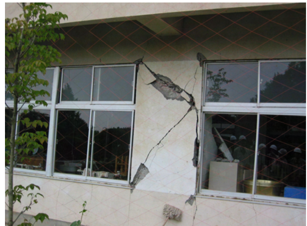
写真2.2 南側・下階壁抜け柱のせん断破壊
