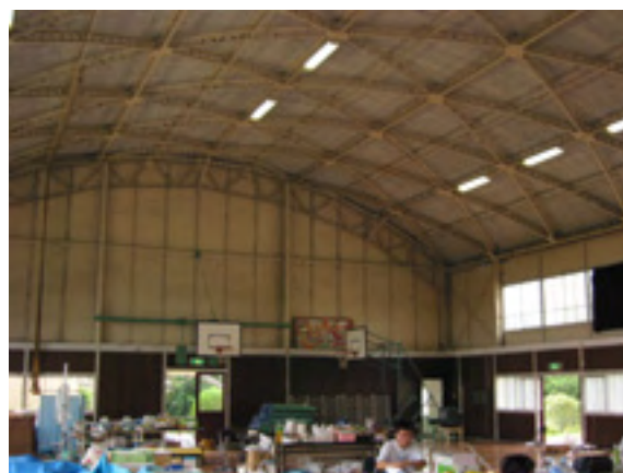
写真2.6 体育館内部 右奥に問題のブレースが見える
