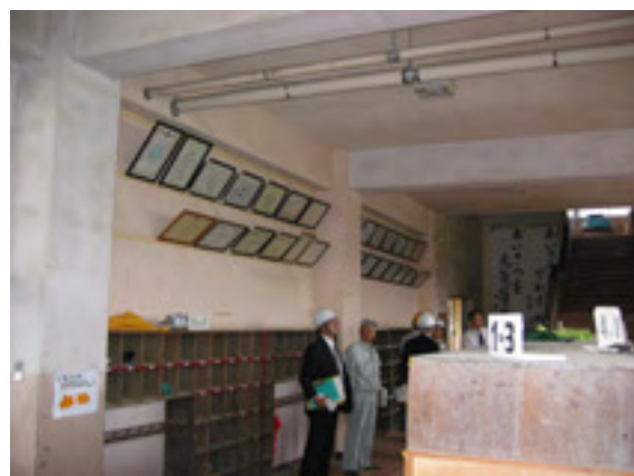
写真1.4 一階の2連の耐震壁（損傷度III）
