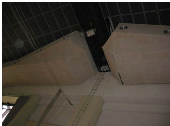
写真4.3 キール梁付近 (天井材がはずれている)
