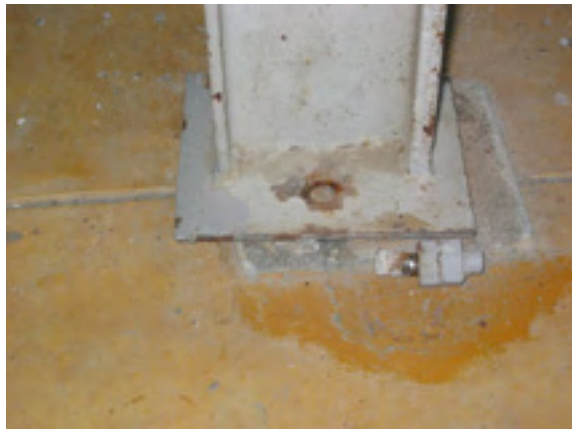
写真5.7 ブレース縦材脚部のアンカーボルトの破断
