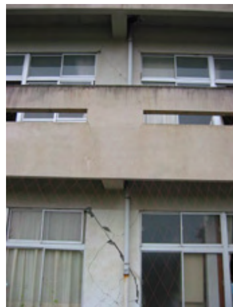
写真2.4 一階および二階柱のせん断ひび割れ
