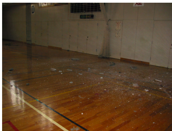
写真4.2 キール梁付近から落下したモルタル片
