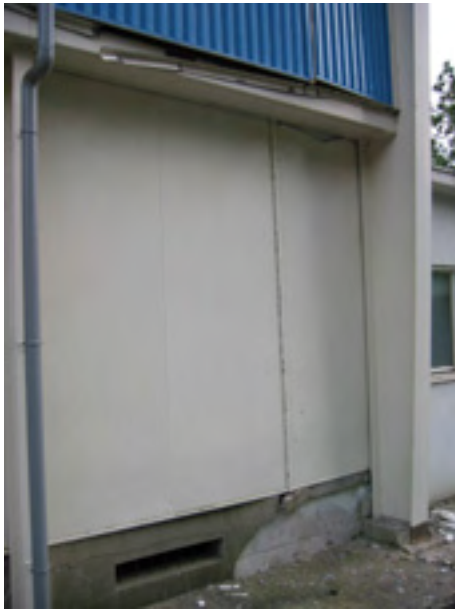
写真2.9 面外にはみ出したパネル
