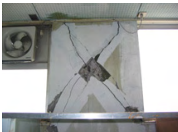
写真1.3 極短柱のせん断破壊
