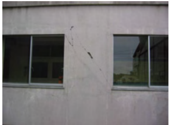
写真3.2 廊下側壁柱のせん断ひび割れ
