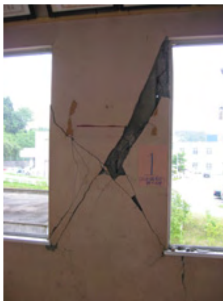
写真1.2 北側柱のせん断ひび割れ
