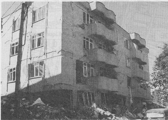
写真2 層崩壊した鉄筋コンクリート集合住宅
