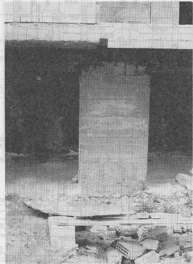
写真10 1階柱付け根の曲げ破壊
