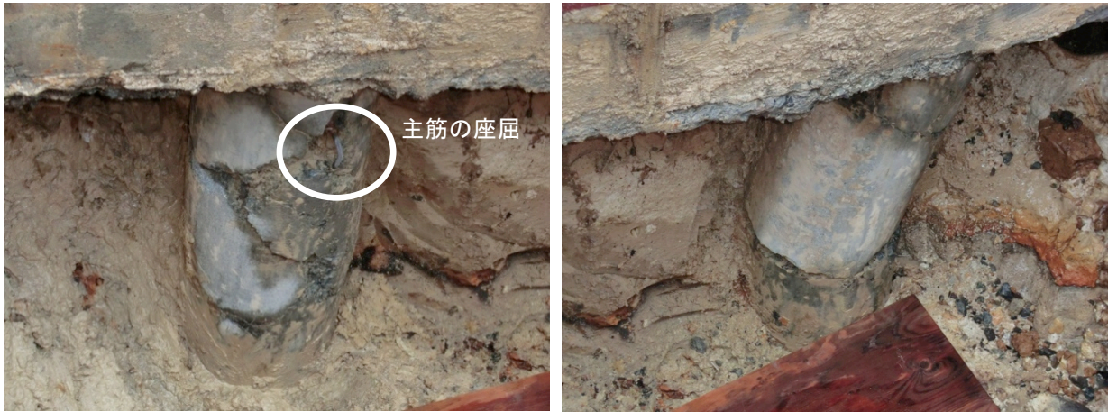
(a) 杭頭のせん断破壊と杭主筋の座屈
