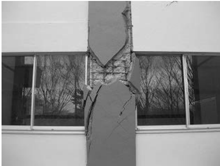
付写真Ⅱ.2-3 西校舎1階短柱のせん断破壊
