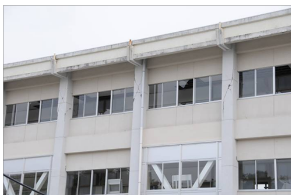
付写真Ⅱ.2-7 3階柱のせん断破壊
