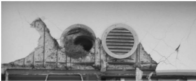
付写真Ⅱ.2-5 並列する連層耐震壁を連結する有孔梁の損傷
