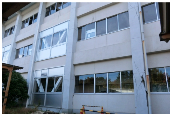
付写真Ⅱ.2-8 鉄骨ブレースに近接した柱のせん断破壊
