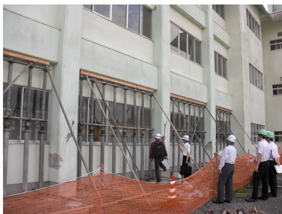
付写真Ⅱ.2-11 せん断破壊した三本の柱
