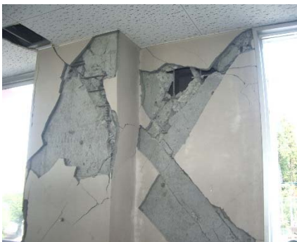
写真-2 H小学校2階C-4柱
