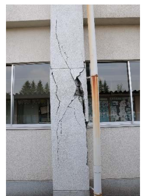
写真-3 1階C-8柱
