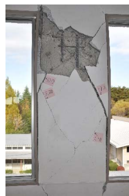
写真-2 3階C-13柱
