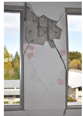
写真5 3階C-13柱のせん断破壊
