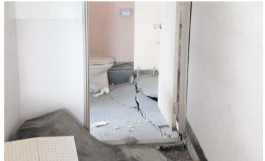
写真3 1階便所スラブの沈下
