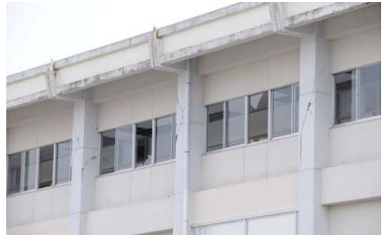
写真2 3階C-11, 12, 13柱のせん断破壊
