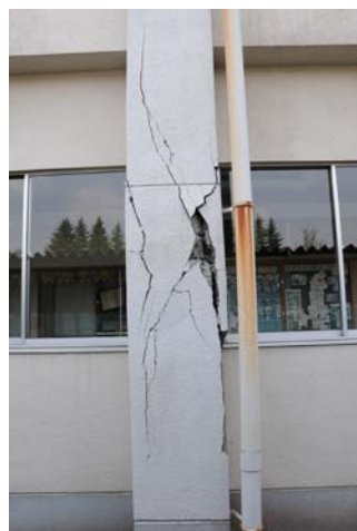
写真4 1階C-8柱のせん断破壊
